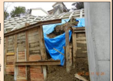
大岡の崖崩れ
